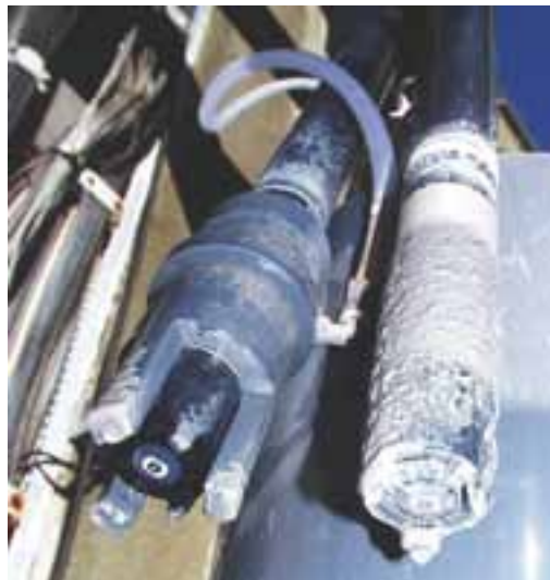
Le nettoyage effectif par air comprimé dans la pratique
